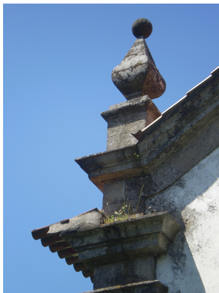
Figura - 9.3 - Todos os elementos horizontais salientes nas fachadas devem receber superiormente aplicação impermeabilizante
