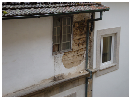
Figura 6.22 – Destaque de argamassa de cal devido à degradação da base de tabique
