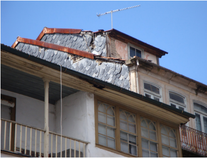
Figura 6.33 - Algerozes e tubos de queda são elementos frágeis e com patologias importantes
