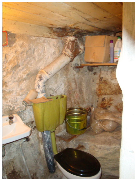
Figura 6.32 – Há diversas instalações de esgoto antigas e deficientes
