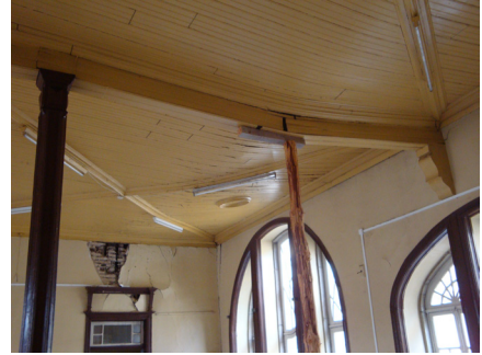
Figura 6.3 – Cedências estruturais por causas diversas, tais como sobrecargas, degradação de materiais, que posteriormente originam outras patologias
