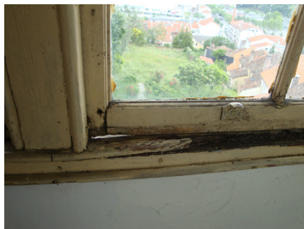
Figura 6.27 – Os caixilhos de madeira são delicados e belos mas cujas patologias são fonte de outras deficiências na construção
