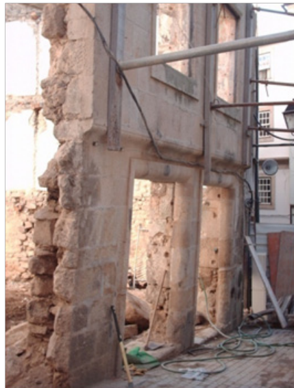
Figura 9.1 – Renovação total do interior com aproveitamento da fachada de cantaria com desalinhamento perigoso
