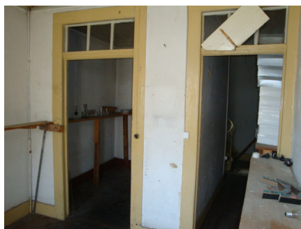
Figura 6.5 - O acesso aos alojamentos em pisos superiores e a evacuação são difíceis como no exemplo com alojamentos até ao 5º piso
