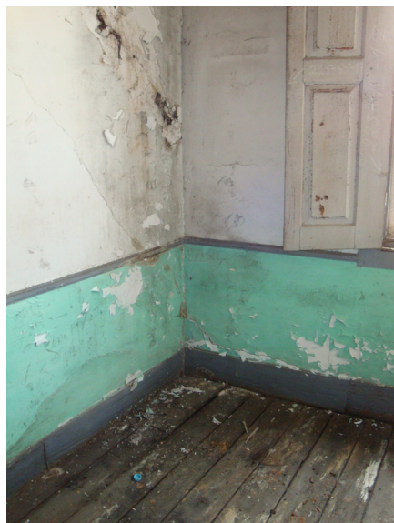
Figura 6.28 – O humedecimento das paredes exteriores propaga-se aos soalhos acelerando a sua degradação
