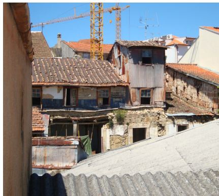
Figura 6.16 – Acrescentos verticais e horizontais para o interior dos quarteirões dificultam ventilação e iluminação em pisos inferiores
