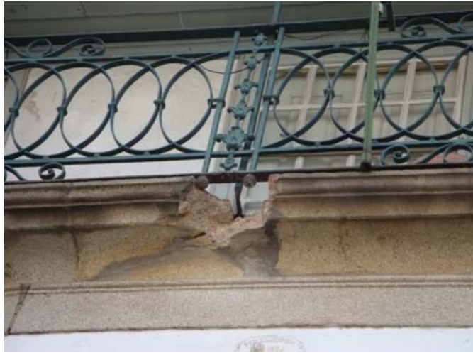
Fig. 6.21 | Oxidação provocando quebra de cantarias com perigo para a circulação pedonal
