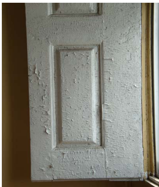
Fig. 9.75 | Com uma boa reparação da pintura está apta a desempenhar eficazmente a sua função por muitos anos
