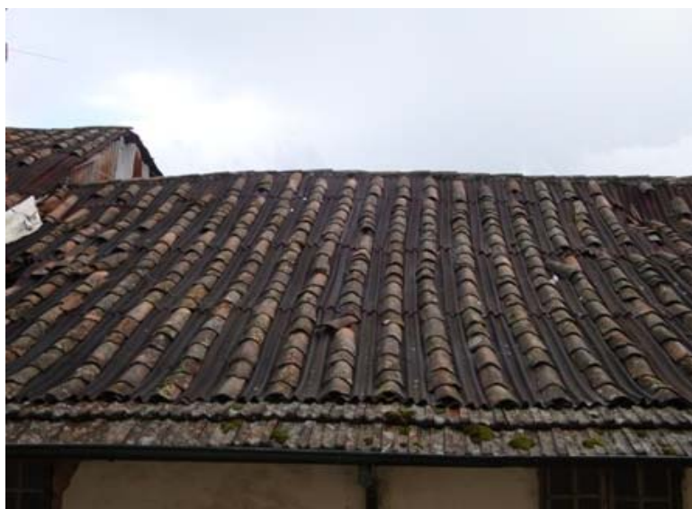
Fig. 6.26 | Os telhados são o ponto crítico cujas patologias são fonte de muitas outras patologias no resto da construção
