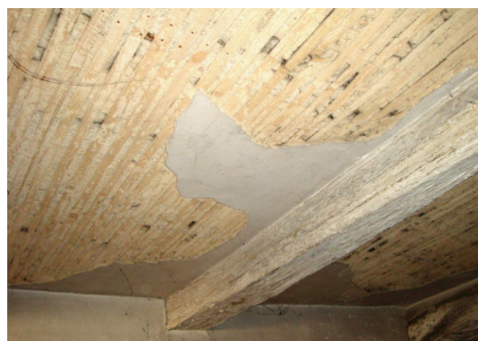
Fig. 6.13. b | Humedecimento e apodrecimento geral de barrote (para afastamento lateral aos adjacentes > 60 cm)
