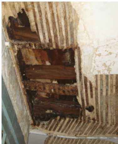
Fig. 6.14. a | Apodrecimento dos vigamentos de madeira, por entrada de água ao nível da
