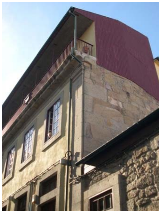
Fig. 9.67 | Os revestimentos de chapa ondulada correspondem à solução de parede exterior delgada e leve usada em pisos superiores nomeadamente os obtidos por acrescentos em estruturas mistas
