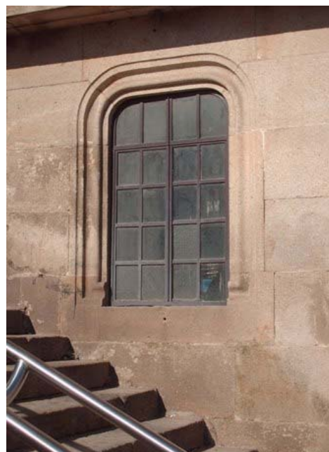
Fig. 9.74 | Recentemente ainda se usam estes perfis de aço por ex.º por razões de alguma segurança
