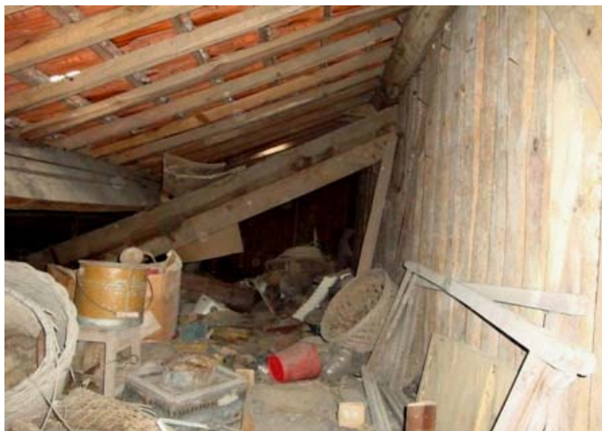
Fig. 6.20 | Há sótãos onde se acumulam poeiras e detritos, com elevado risco de ignição de incêndio
