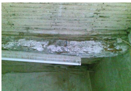
Fig. 6.13. a | Rotação e deterioração de apoio de vigamento na zona de entrega numa paredemestra por ataques vários
