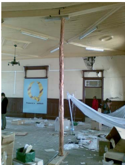
Figura 6.12 | Anomalias em pavimentos de madeira por deformabilidade excessiva (local e global):
