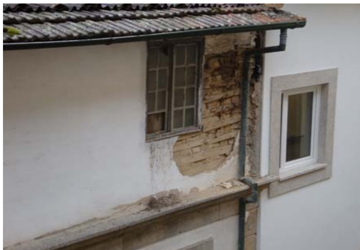
Fig. 6.22 | Destaque de argamassa de cal devido à degradação da base de tabique por perda estabilidade e estanqueidade
