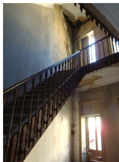
Fig. 6.2 | Efeitos das infiltrações pelas coberturas e respectivas redes de drenagem das águas pluviais, muito degradadas
