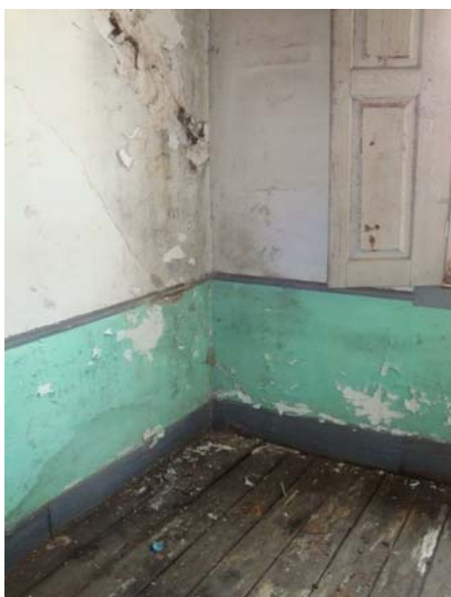
Fig. 6.28 | O humedecimento das paredes exteriores propaga-se aos soalhos acelerando a sua degradação
