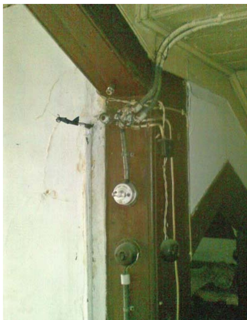
Fig. 6.34. a | Instalação eléctrica em estado obsoleto
