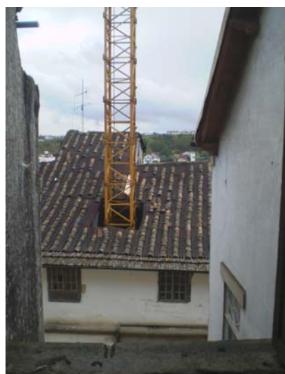
Fig. 10.3.b | Restrição no equipamento de elevação de cargas
