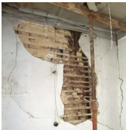
Fig. 6.11. a | Parede interior estrutural do tipo tabique “prancha ao alto” afectada pela presença de humidades
