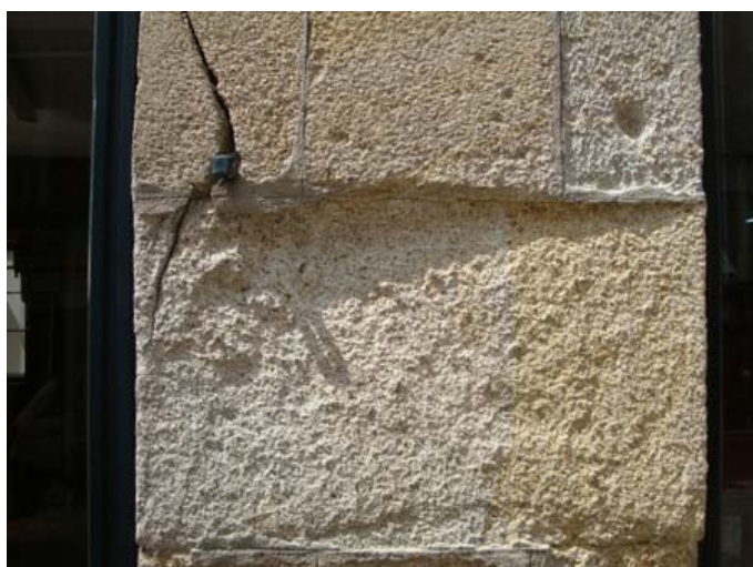
Fig. 9.87 | Exemplo de desagregação que apresentam alguns tipos de granito e que afectam especialmente os revestimentos pela sua reduzida espessura o que não aqui o caso
