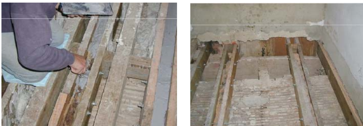
Fig. 9.33 | Exemplo de reparação e reforço de pavimento com novos vigamentos “artificiais” (extraído de [14]):
