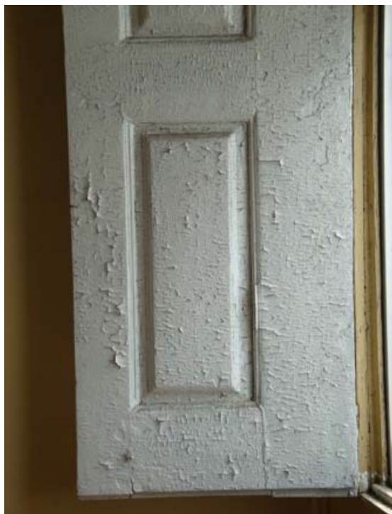
Fig. 6.31 | Portadas interiores com pintura degradada pela má aplicação e pela exposição solar
