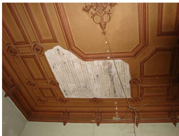
Fig. 9.86 | Tecto falso de estuque sobre fasquiado com molduras de gesso e pintura a reparar e acabar com nova pintura geral
