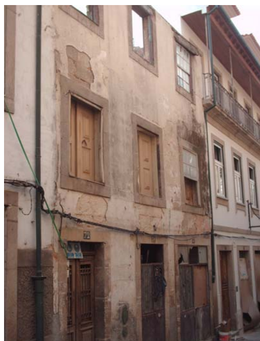
Fig. 2.19 | Casa em ruína
