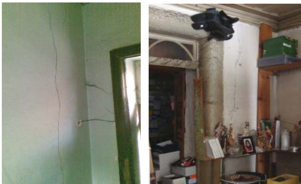
Fig. 6.10 | Fendas verticais na zona de ligação ortogonal entre paredes de alvenaria de granito “média qualidade”
