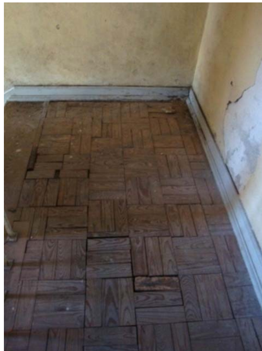
Fig. 6.7 | Patologias decorrentes de problemas nas fundações: humidade no pavimento de um piso térreo, com proveniência desconhecida (por ascensão capilar ou escorrência pluvial ou outra)
