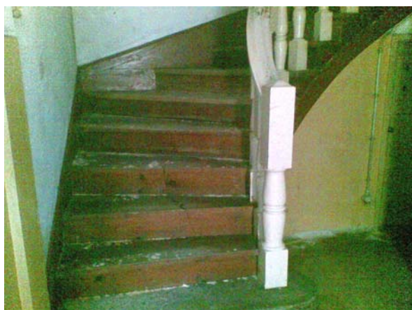
Fig. 6.15. a | Apodrecimento do lanço de arranque de uma escadaria de madeira, pela presença de humidades ao nível do piso térreo, com ataques de fungos e térmitas
