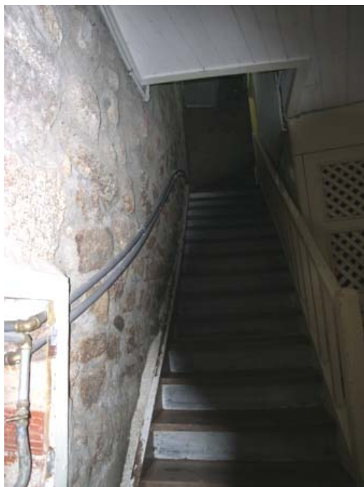
Fig. 6.32.a | Tubagem de água potável à vista
