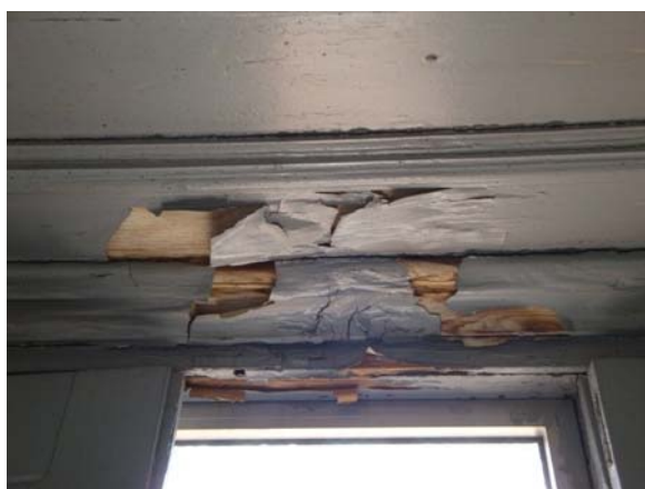
Fig. 6.33. a | Caleiras degradadas responsáveis por estas patologias
