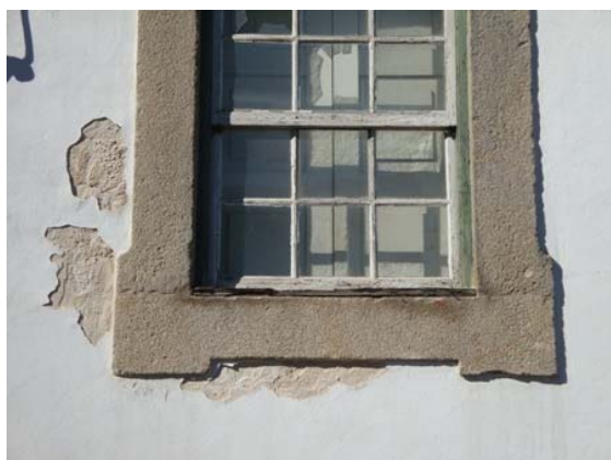
Fig. 6.23 | A humidade arrastando sais da alvenaria devido ao vão destacam a pintura exterior
