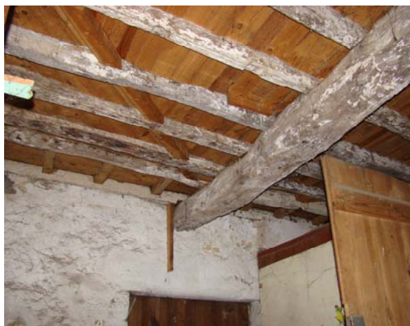
Fig. 9.81 | Substituição de soalho por outro por similar mantendo a estrutura que estava em boas condições
