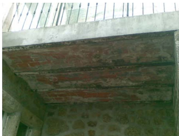
Fig. 6.15. b | Oxidação de perfis metálicos visível no tecto de um pavimento de abobadilha de acesso a um edifício, por falta de estanquidade à água e ausência de protecção
