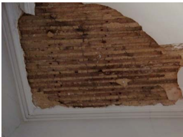
Fig. 9.85 | Tecto falso de gesso sobre fasquiado de argamassa de cal a reparar com os mesmos materiais
