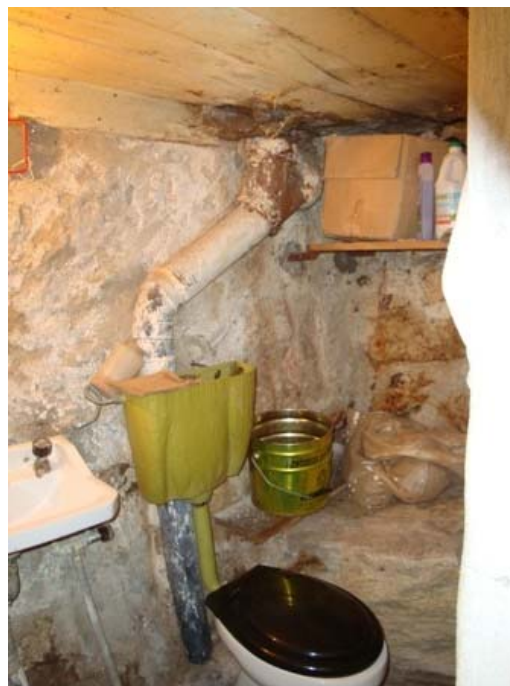
Fig. 6.32.b | Tubagem da rede de águas residuais domésticas
