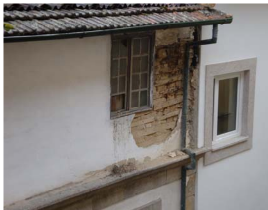
Fig. 6.11. b | Parede exterior estrutural do tipo tabique “prancha ao alto” patologicamente afectada pela escorrência de águas
