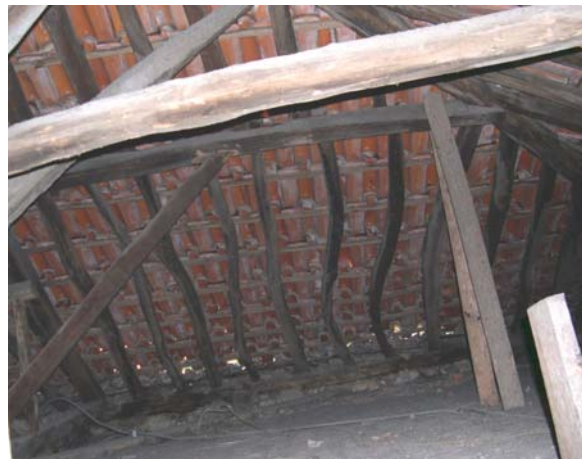
Fig. 6.14. b | Encurvadura geral de elementos de madeira (e.g., madres) numa cobertura por telhado inclinado
