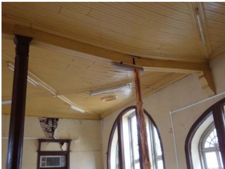
Fig. 6.3 | Há cedências estruturais por causas diversas, por sobrecargas, degradação do material por diversas razões que depois originam outras patologias
